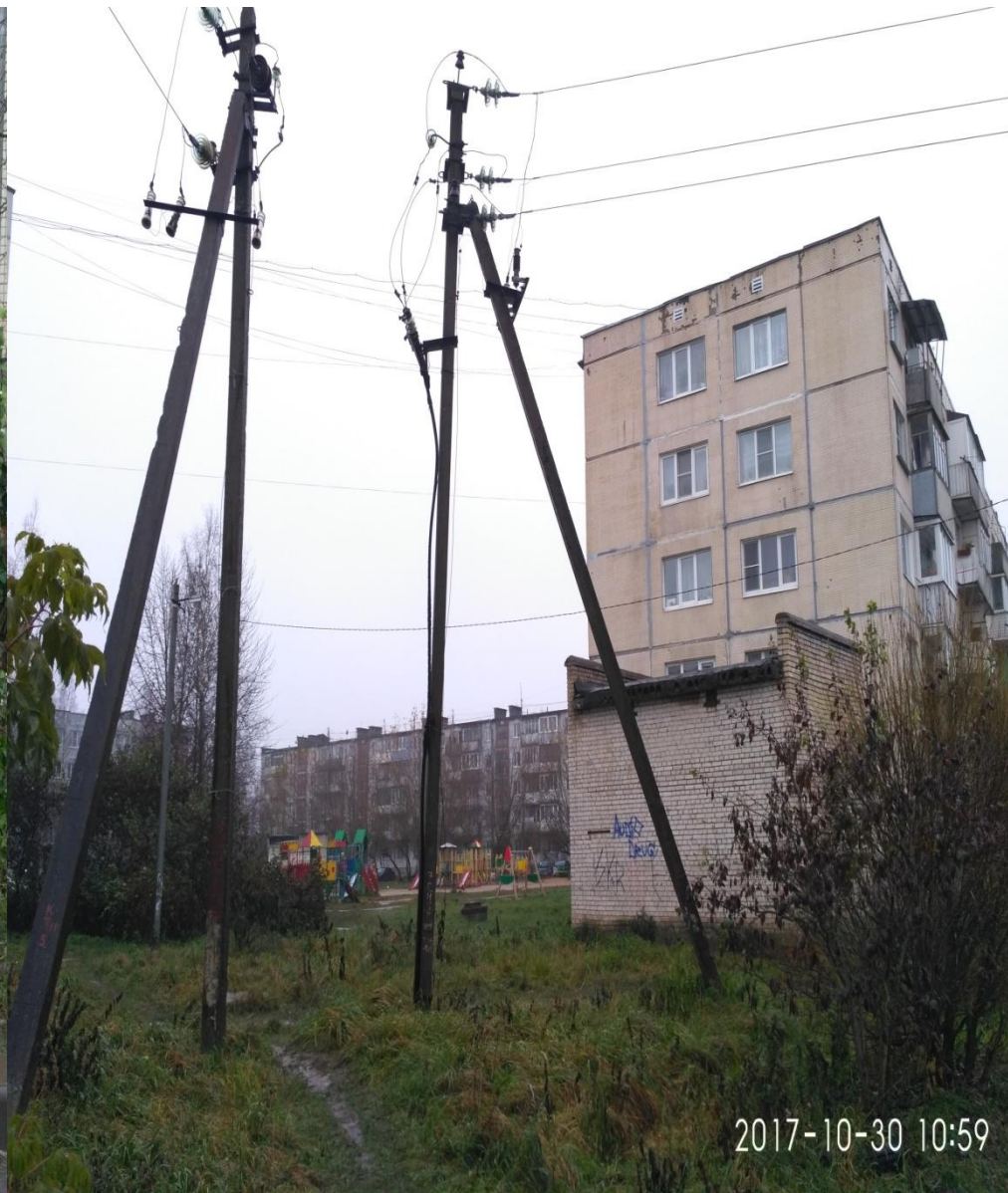
вид на опоры и подстанцию
